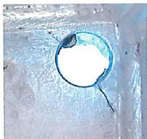
図1 めっき割れ例
